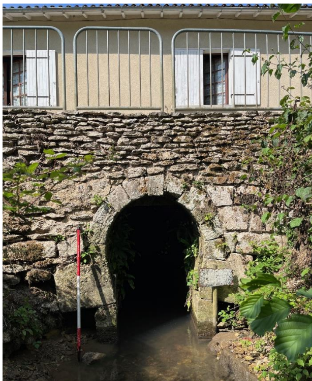
Déformation prononcée des piédroits et affouillement
