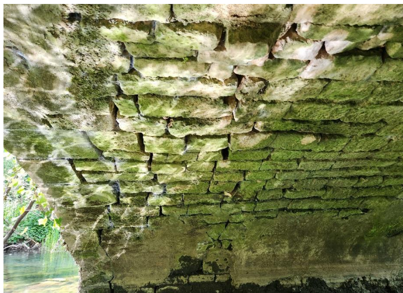
Décollement du bandeau et disjointoiement généralisé
