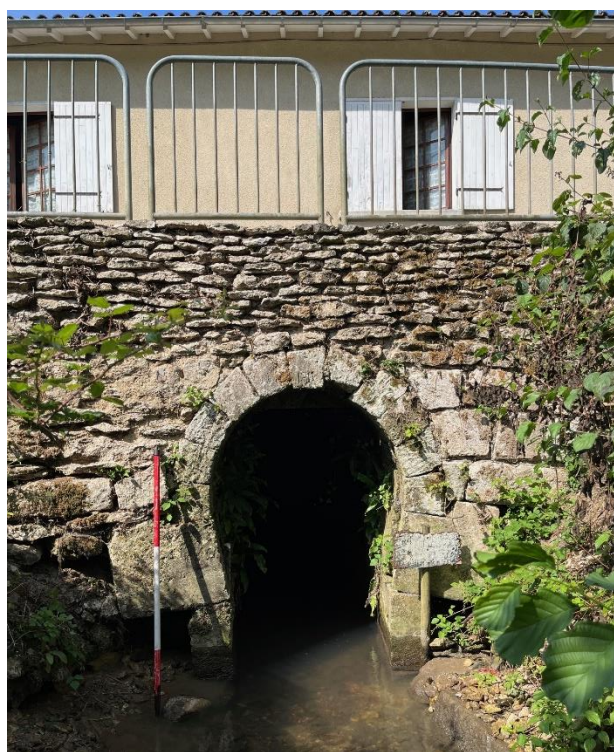
Déformation prononcée des piédroits et affouillement
