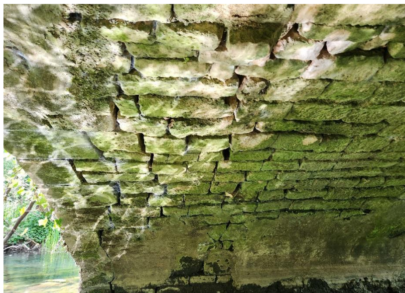
Décollement du bandeau et disjoints généralisés
